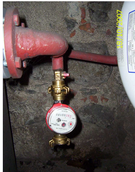
Bild 16 – Bestimmung der Volumenmenge im System durch Entleerung über den Wohnungswasserzähler
