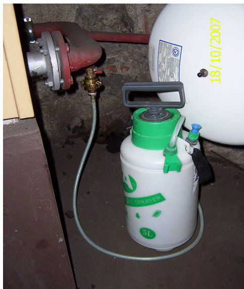
Bild 18 – Füllung der Flüssigkeit in das System
